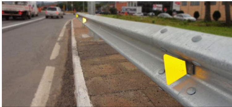
Figura 13.5 - Refletivos para defesa metálica.
