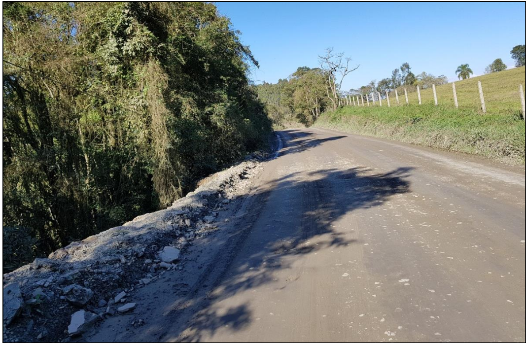
Figura 3.3 – Estaca 0+660 – Travessia com problemas.
